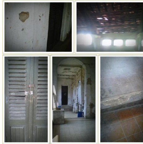
Gambar 3. Kerusakan pada bangunan Lawang Sewu
