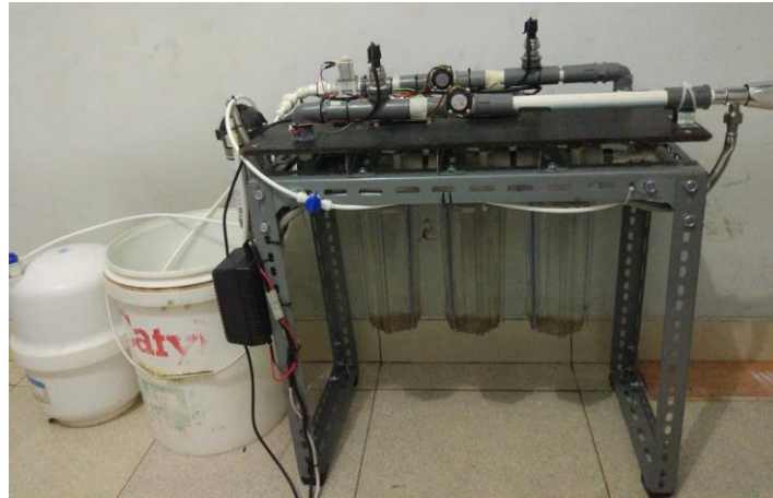
Gambar 5 Rangkaian Alat Proteksi Kebocoran pada Prototipe Mesin Reverse Osmosis
