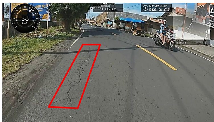
Gambar 6. Kerusakan retak memanjang pada Sta. 1 + 100 – Sta. 1 + 200
