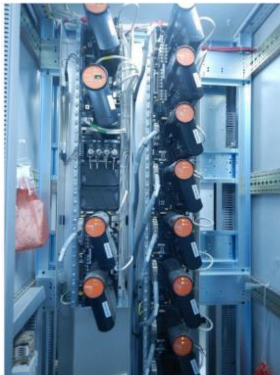
Gambar 4. Controller di Unit Control Room di PT Kilang Pertamina Balikpapan
