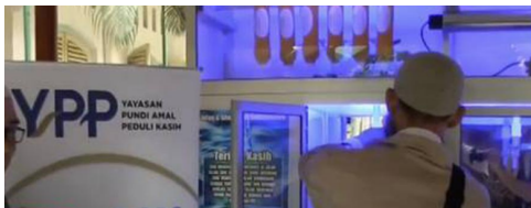
Gambar 2. Instalasi Air Isi ulang Bantuan Indosiar Untuk Panti Asuhan Siti Khadijah Lenteng Agung Jakarta
